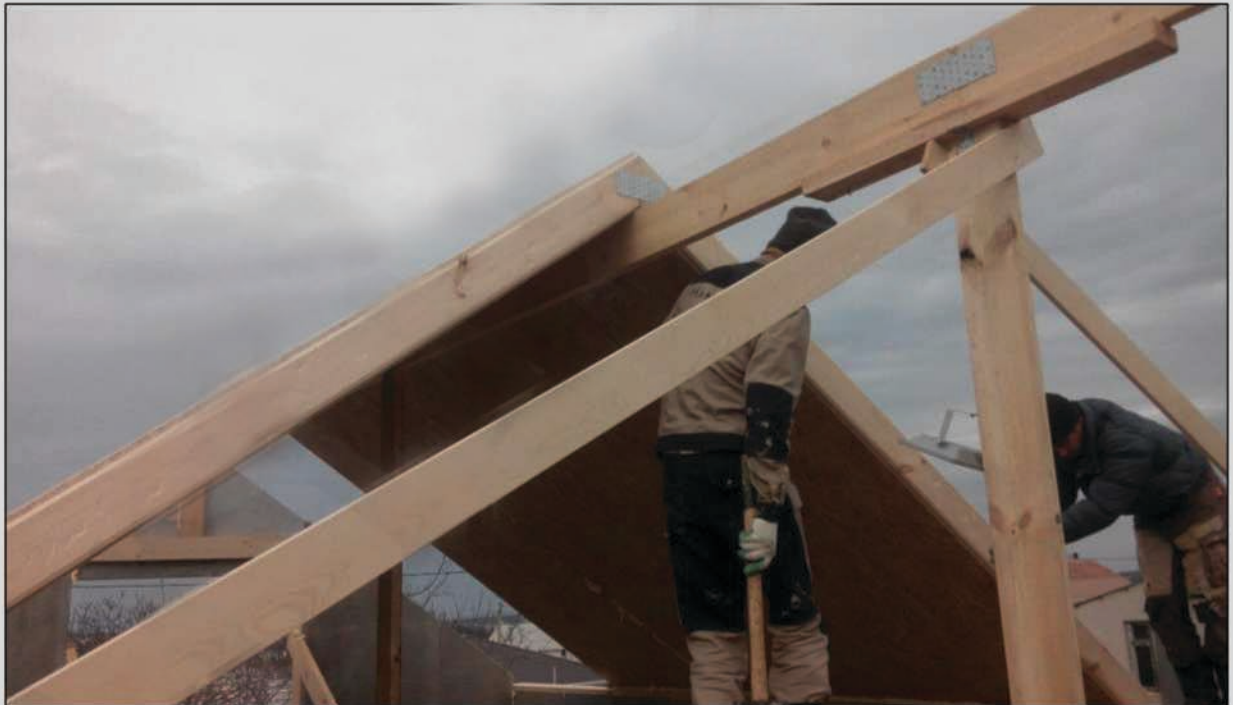
Рис. 15 Узел конькового стыка кровельных панелей с применением конькового бруса и поперечных прогонов
